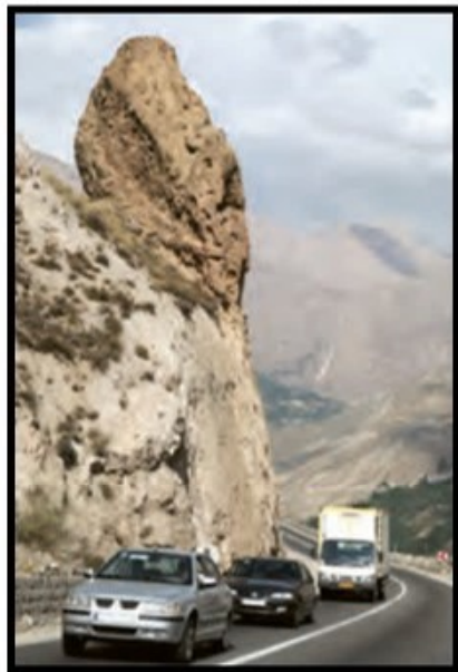
سنگ در آستانه سقوط
